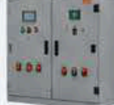
ATS PANELS لوحات ATS
